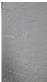
IMAGEN 17: Grieta en uno de los paneles.
